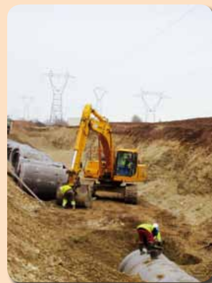
Découpage préalable avant enfouissement d'une canalisation pour sécuriser l'utilisation d'une pelle de grandes capacités
