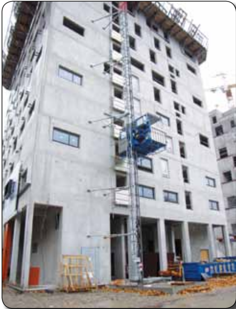
Ascenseur de façade
