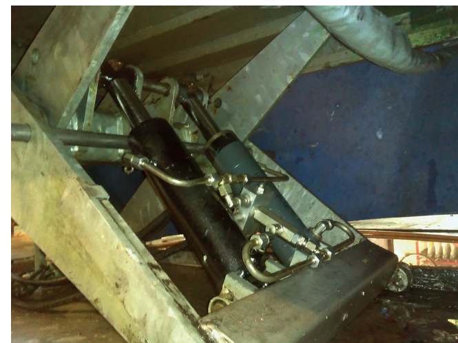
Mécanisme de la table élévatrice à graisser. (Photo © Carsat).
