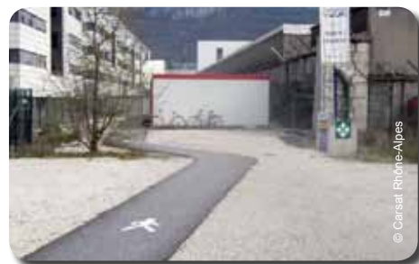
Accès chantier GSE : Chantier SCI BCC PRESQU'ILE/CREDIT AGRICOLE. La circulation des piétons est définie précisément et recouverte d'enrobé
