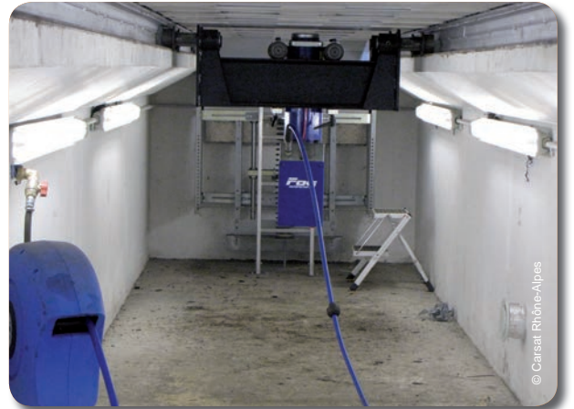
Fosse de visite ventilée, équipée d'un cric roulant pour les interventions sur poids lourds
