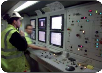
Cabine de pilotage - Tunnel de Gerland
