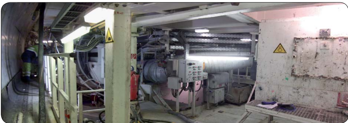
Poste injecteur - Tunnel de Fréjus
