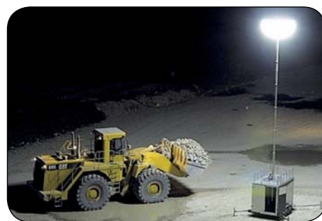
Dispositif d'éclairage de chantier du type « Ballon »
